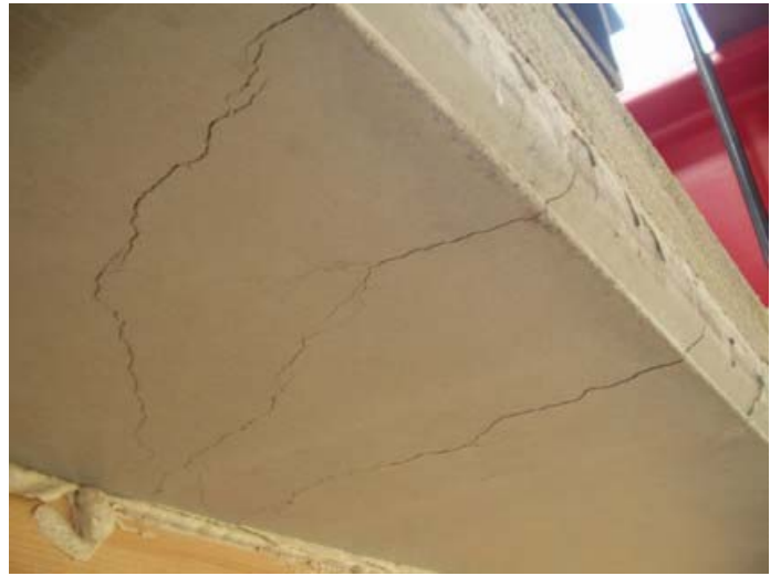
Risse im Beton
