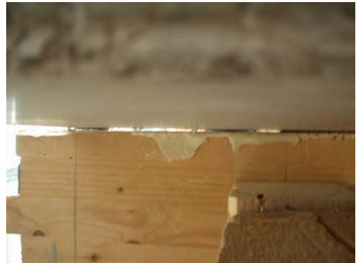
Ablösen der Filigrandecke im Auflagerbereich
