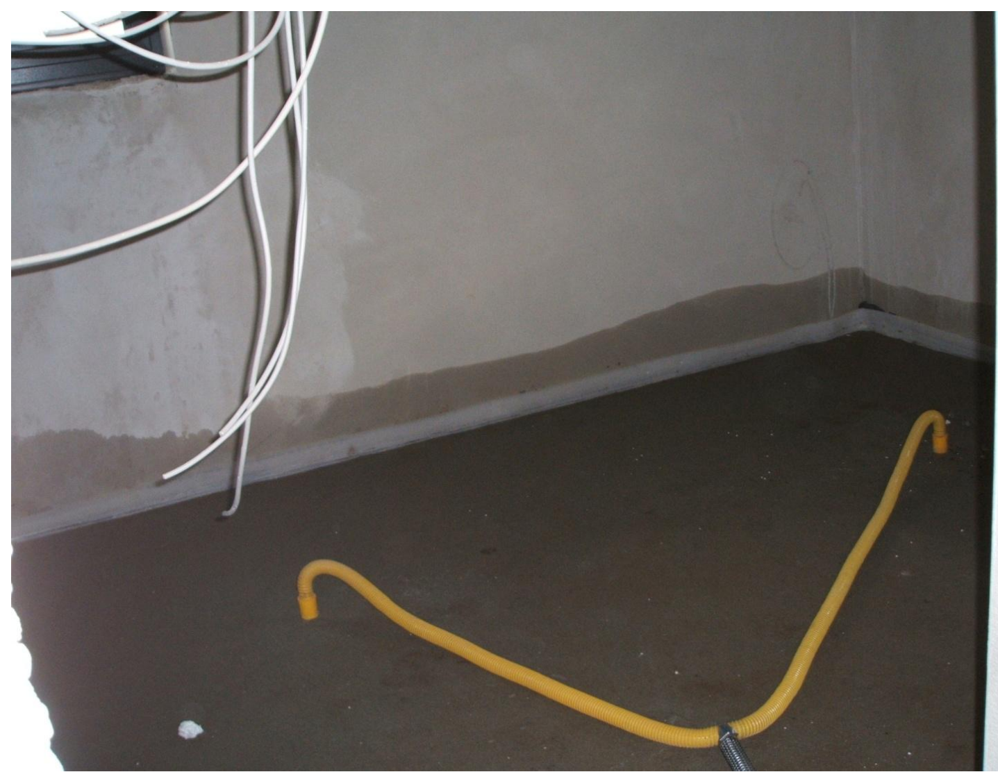
Abb. 1 aufsteigende Feuchtigkeit an Wänden
