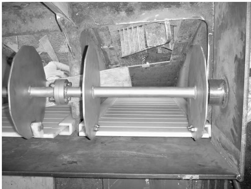
Innenansicht von oben in den Seekasten
